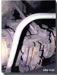
a / Fuite de gaz en amont de la chaudière
